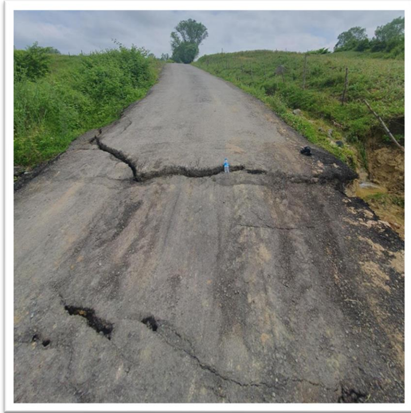
Şekil 11. Kütle Hareketi Sonucunda Zarar Gören Uzgur Mahallesi Yolu.
